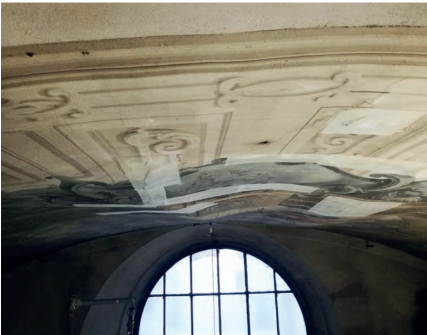
Sopra: FIGG. 3A-B Dettagli dell'intradosso della volta, con fenomeni di dilavamento e distacco della pittura
