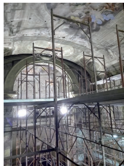
FIG. 1B Vista dell'aula occupata dalla struttura provvisoria di soattegno alla volta e alla cupola
