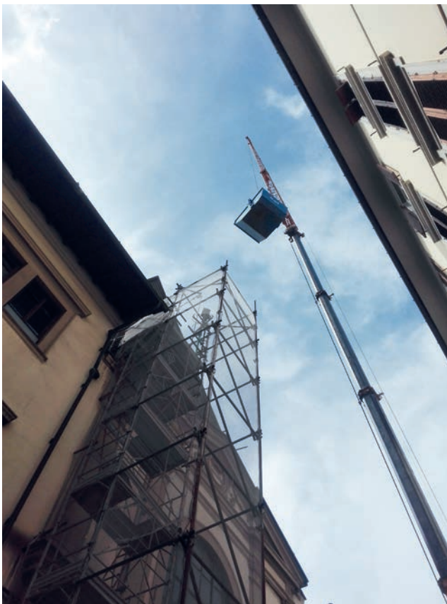
FIG. 2 Il ponteggio di facciata che contiene gruppo scale e castello di tiro per l'accesso in autonomia al cantiere
