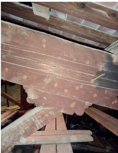
FIG. 5 Particolare unione puntone saetta con interposizione di dormiente ligneo
