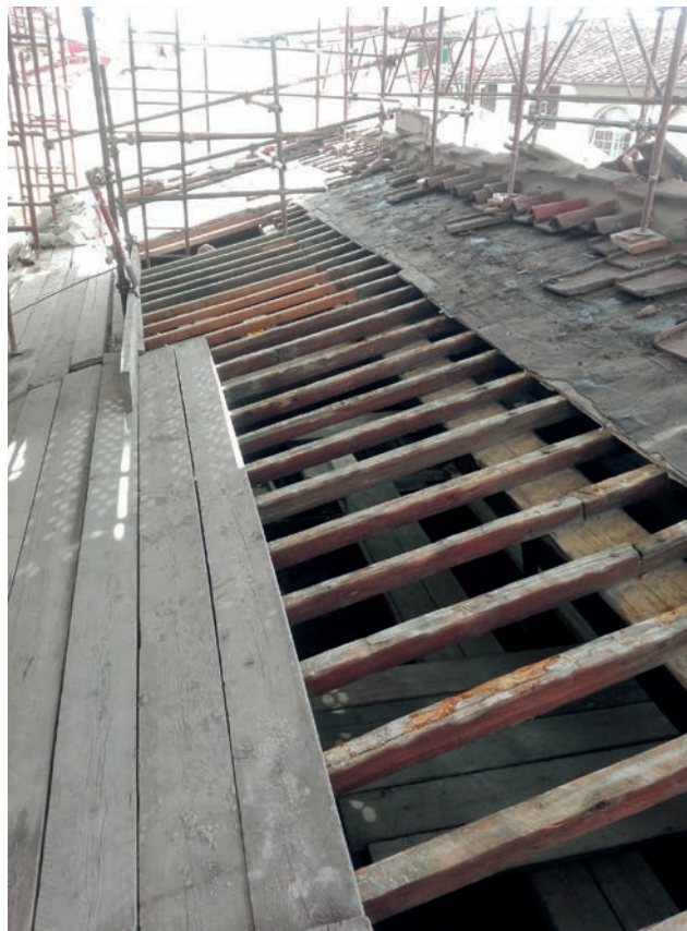
FIG. 3 La porzione del tetto smontata per permettere aereazione illuminazione e ventilazione alle maestranze impegnate nel sottotetto
